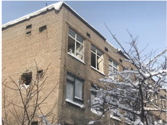
Помітні пошкодження будівлі школи №42 в невідконтрольному урядові Вуглегірську, 2018 р.
