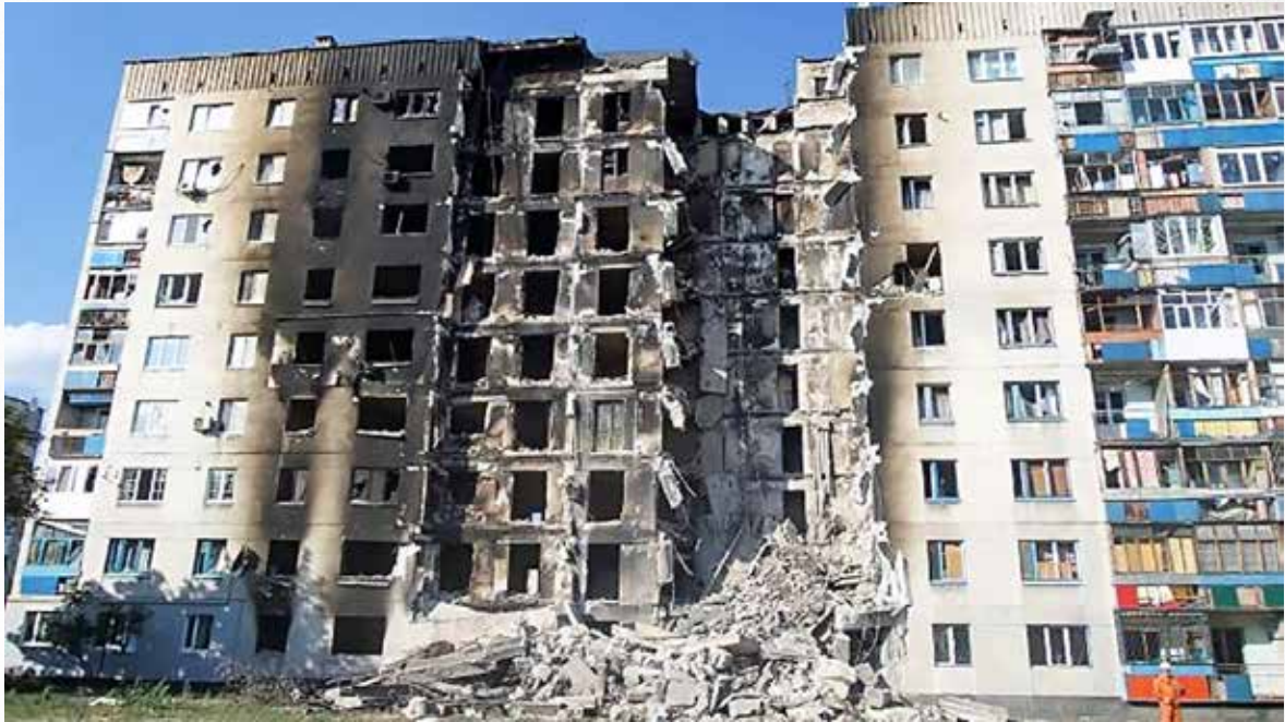
Зруйнований будинок в м. Лисичанську, в якому мешкала респондентка
