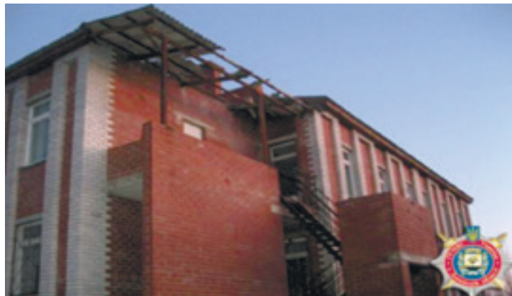
2 Рис. 1. Повреждение крыши здания детского сада «Лелеченька», г. Бахмут, улица 1 Загородная, 22, 13 февраля 2015 года, фото представителей ГУ МВД Украины в Донецкой области 2
