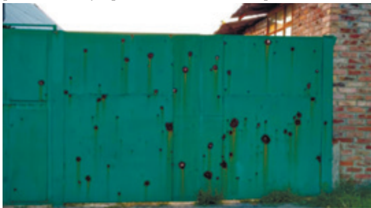
Рис. 4. Ворота частного дома, поврежденные осколками, г. Бахмут, улица Шевченко, 91, 18 сентября 2017 года, фото сделано М. Беляковой
