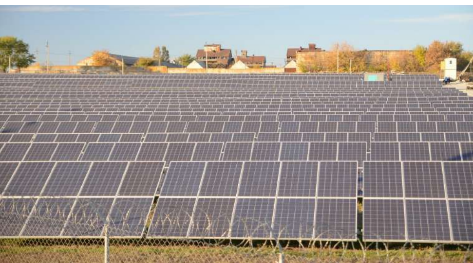
Сонячні панелі Tokmak Solar Energy. Джерело фото: Tokmak Solar Energy
