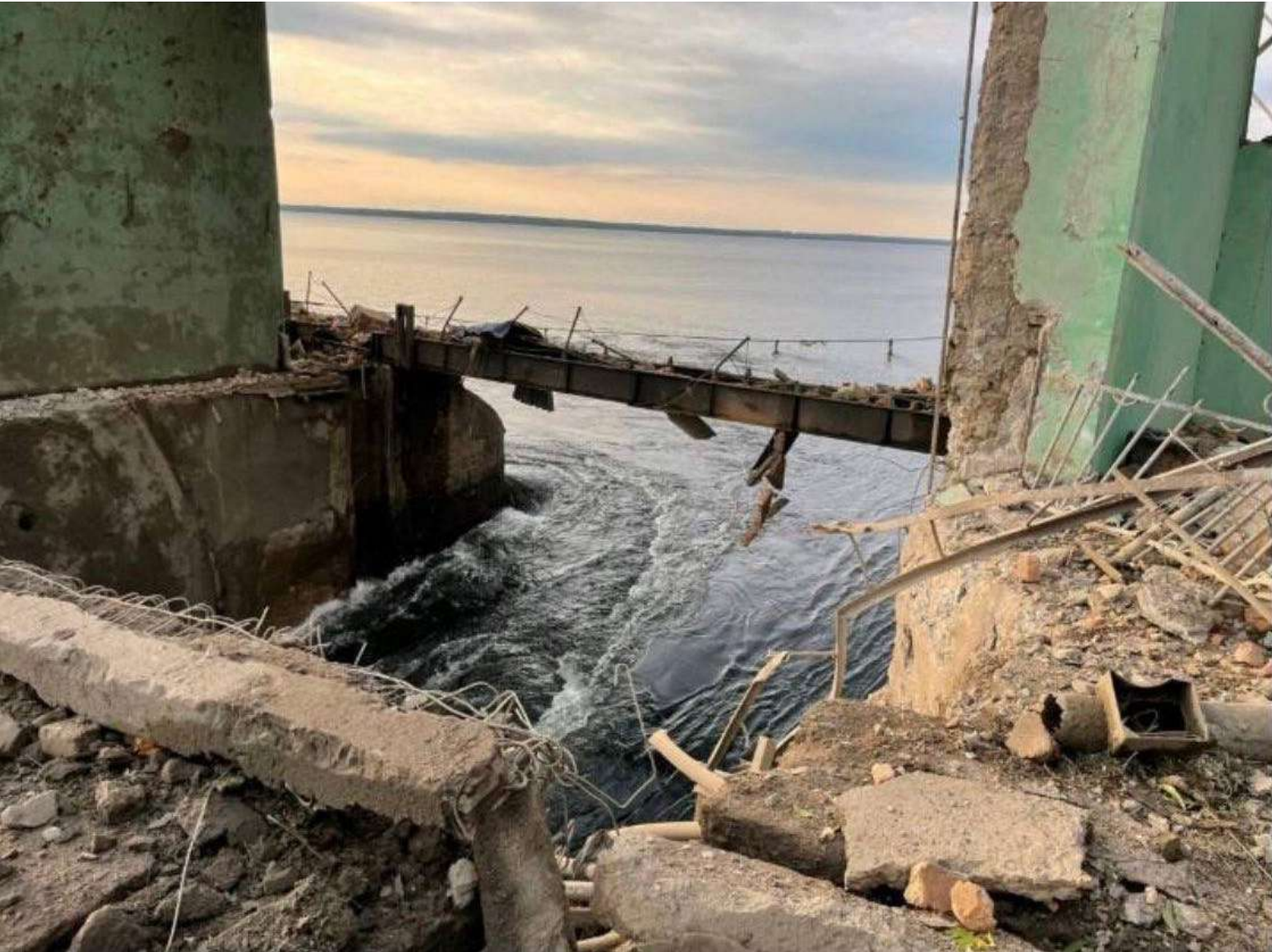
Наслідки удару по гідротехнічних спорудах в Кривому Розі 14 та 16 вересня. Джерело фото: Новинарня
