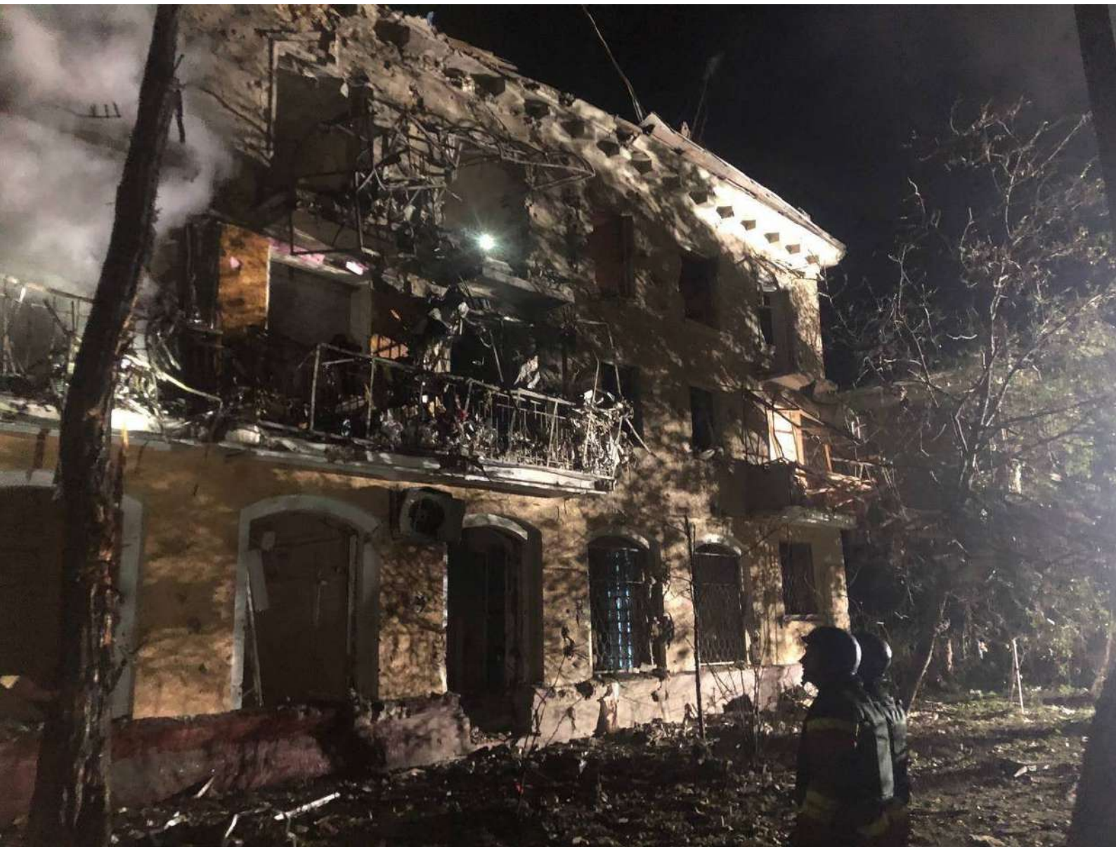
Багатоквартирний будинок в Запоріжжі після ракетного удару 24.09.22. Джерело фото: Олександр Старух / Запорізька ОДА (ОВА)
