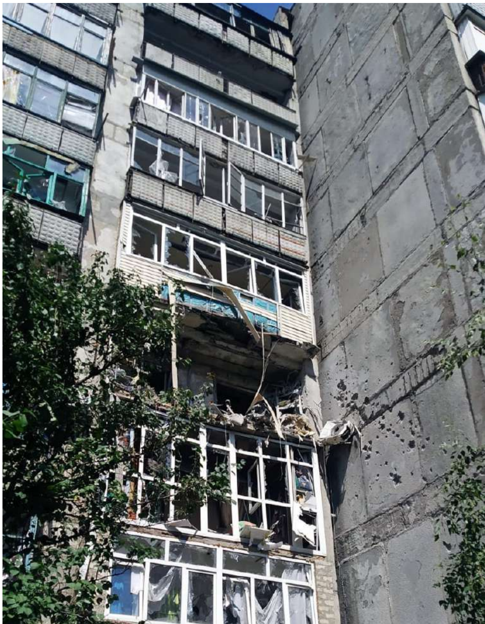
Пошкоджений багатоквартирний житловий будинок в Торезьку, 04.08.2022. Джерело фото: Павло Кириленко
