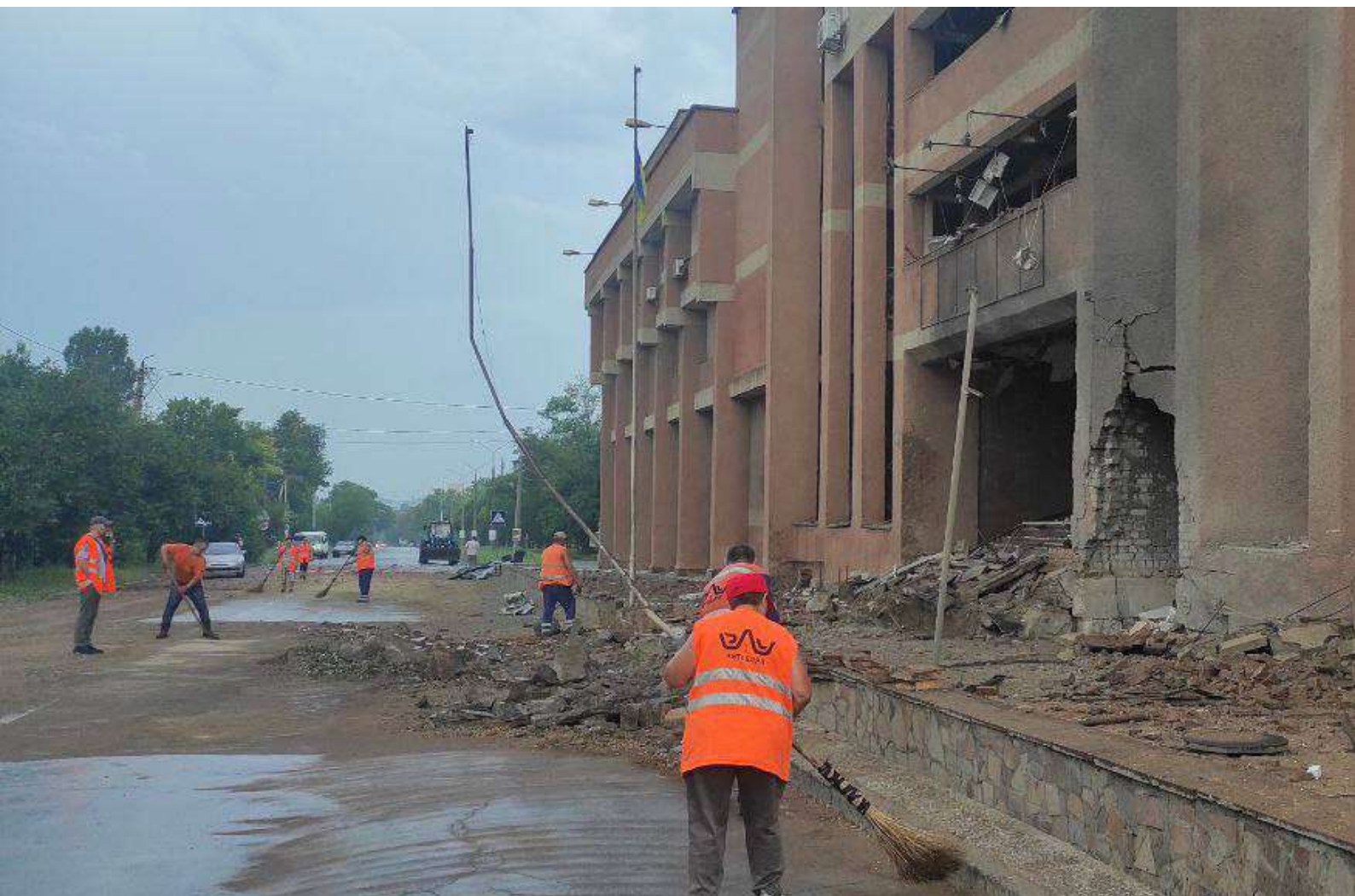
Будівля університету в Миколаєві після ракетного удару, 17.08.2022. Джерело фото: «Сенкевич Online»
