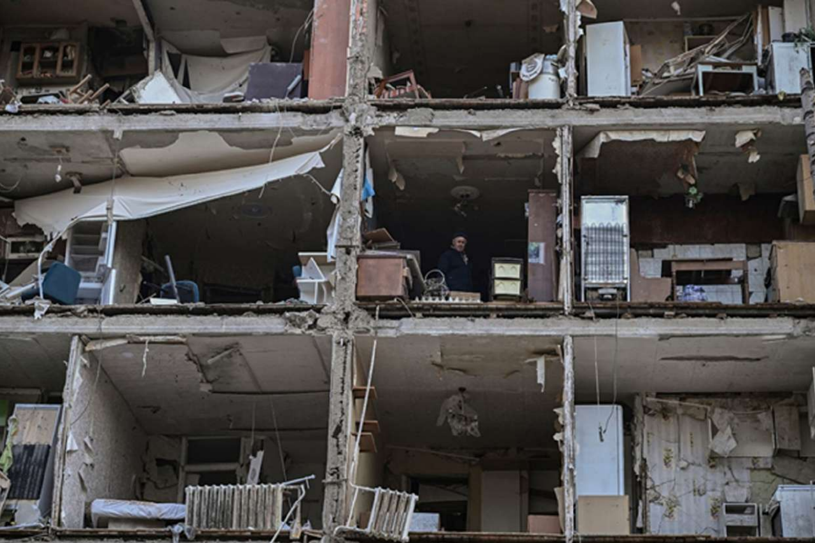
Руйнування житлового будинку в Харкові, березень 2022 року. Фото: Aris Messinis
